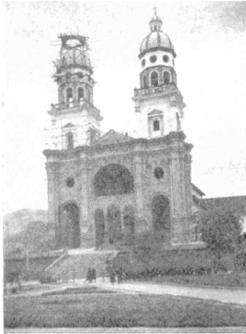
Figura 5. Torre de la Iglesia de Santiago afectada por el sismo del 14 de Julio de 1947 (Ramírez, 1948).
