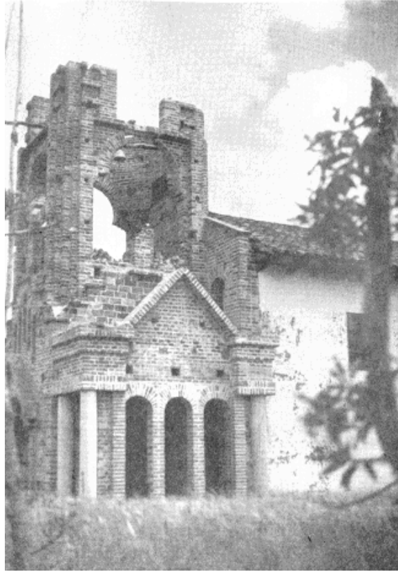
Figura 7. Daños en la torre de la Iglesia de Pandiaco en el Sismo del 14 de Julio de 1947 (Ramírez, 1948).
